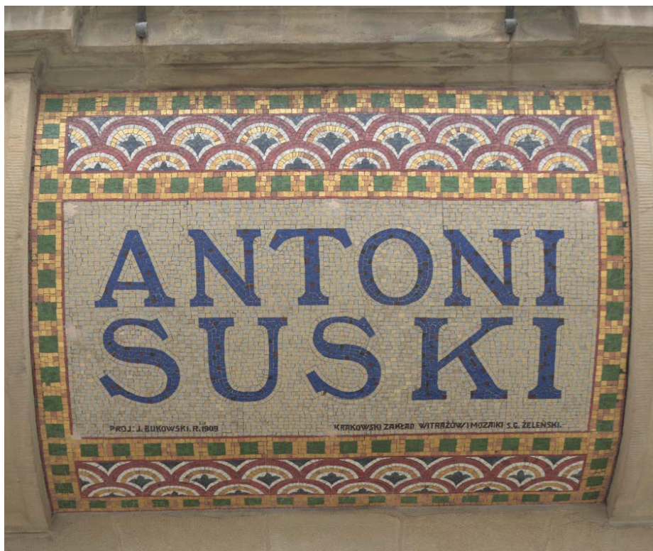
Fot. 62. Podpisy rzemieślników, ul. Grodzka 26 / pl. Dominikański 6, kamienica „Suskich”, proj. Władysław Ekielski, 1906-1910.
